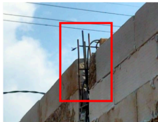
Gambar 31. Kesalahan Detailing antar Kolom dengan Balok
