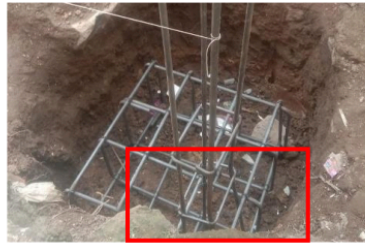
Gambar 25. Kesalahan Pengangkuran Fondasi
