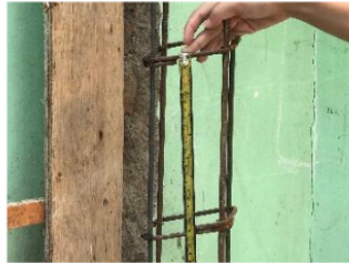
Gambar 27. Kesalahan Jarak Sengkang Kolom
