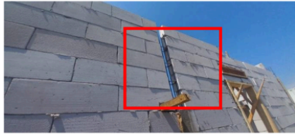
Gambar 30. Kesalahan Detailing Pengankuran Dinding
