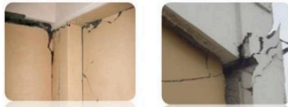
Gambar 8. Kerusakan akibat Penurunan Fondasi
