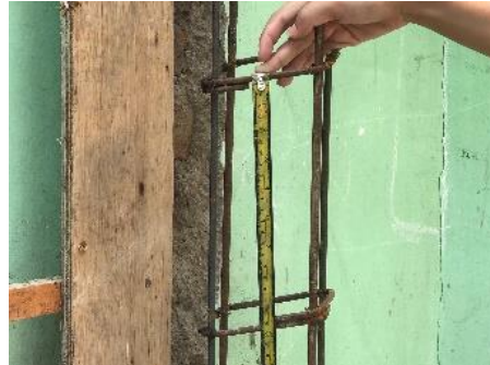
Gambar 27. Kesalahan Jarak Senggang Kolom
