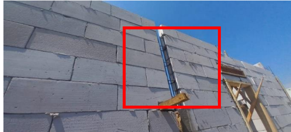
Gambar 30. Kesalahan Detailing Pengankuran Dinding
