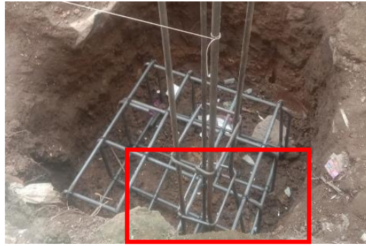
Gambar 25. Kesalahan Pengangkuran Fondasi
