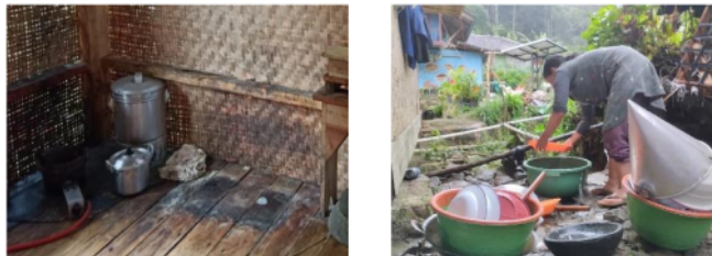
Gambar 3. Kondisi Lantai yang Terbakar Akibat Panas dari Kompor dan Area Pencucian Saat Ini
