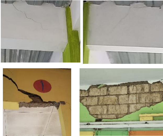
Gambar 2. Kegagalan geser pada elemen balok pada gedung SMP Garnesia dan SMP Plus Assyuthiyyah
