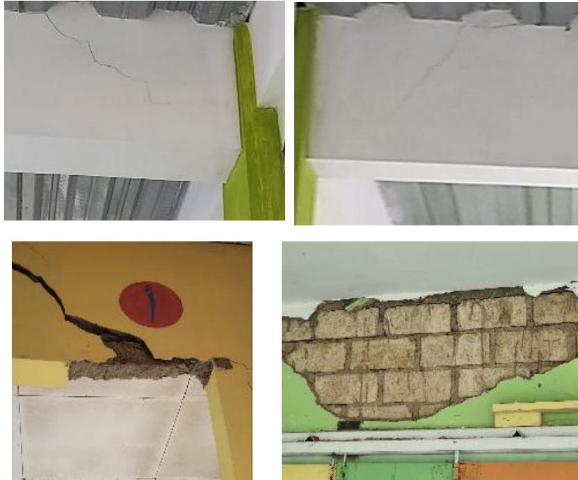
Gambar 2. Kegagalan geser pada elemen balok pada gedung SMP Garnesia dan SMP Plus Assyuthiyah
