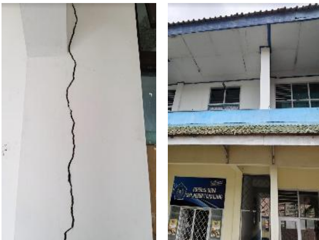
Gambar 3. Kegagalan retak elemen kolom pada gedung SMPN 1 Cianjur
