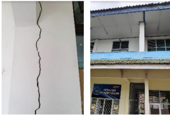
Gambar 3. Kegagalan retak elemen kolom pada gedung SMPN 1 Cianjur
