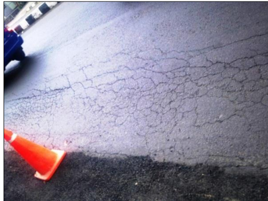
Gambar 1 Jenis Kerusakan Alligator Cracking
