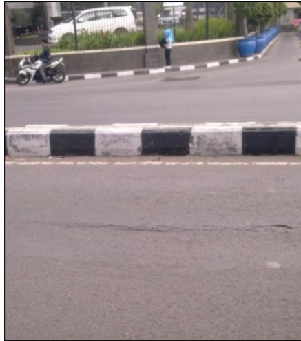
Gambar 18 Jenis Kerusakan Rutting
