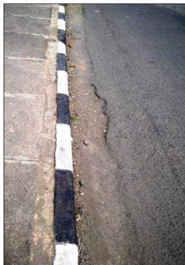
Gambar 15 Jenis Kerusakan Edge Cracking
