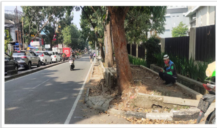
Gambar 6 Kondisi awal trotoar yang rusak
