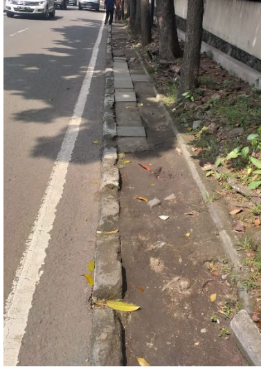
Gambar 3 Kondisi Trotoar yang Rusak
