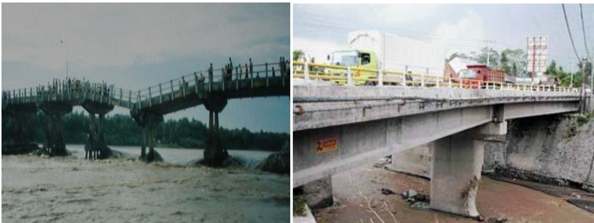
Gambar 1.1 Kegagalan struktur jembatan akibat penggerusan
