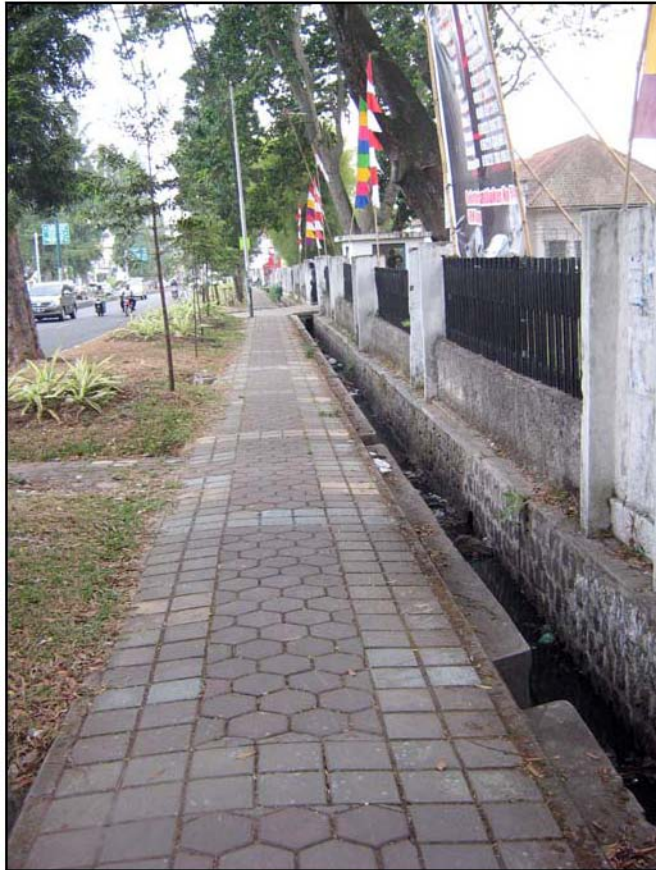
Gambar L3.3 Kondisi pedestrian jalan Ir. H. Juanda
