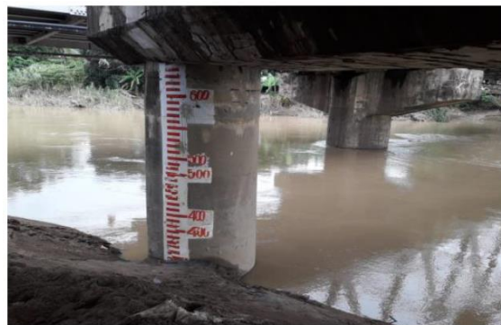
Gambar 7-6 Kondisi Pilar Jembatan Cipunegara (Pusjatan 2019) (sumber: Setiati, N. R dan Kurniawati, E. 2021)
