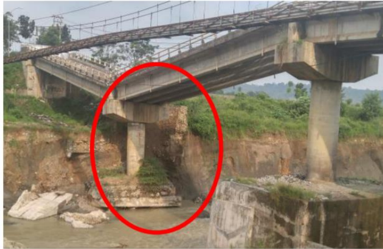
Gambar 1-8 Pilar Jembatan Cipamingkis mengalami Penurunan ( sumber: Setiati, N. R, et. al. 2019 )
