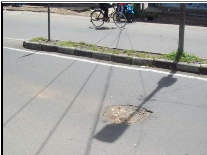
Gambar L2.4 Kondisi Perkerasan Berlubang di Jl. Gatsu – Jl. Laswi
