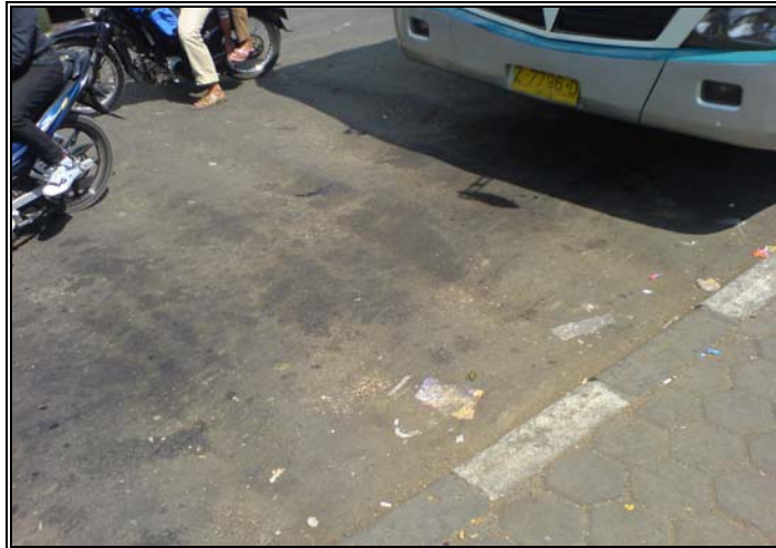
Gambar L2.3 Kondisi Perkerasan Bergelombang
