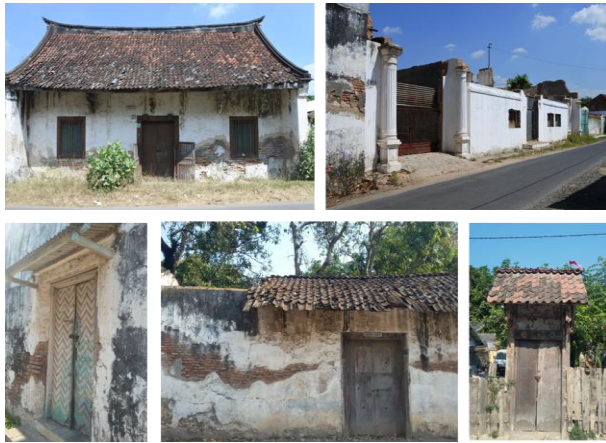
Gambar 1. Berbagai Kerusakan Gerbang dan Rumah Peranakan Tionghoa di Lasem, Jawa tengah (Sumber : Dokumentasi Penulis, 2017-2019)
