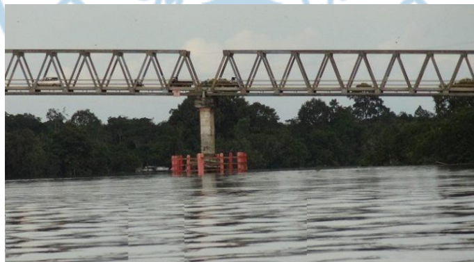
Gambar 1.1 Jembatan Bajarum Sampit Terancam Ambruk Ditabrak Tongkang
