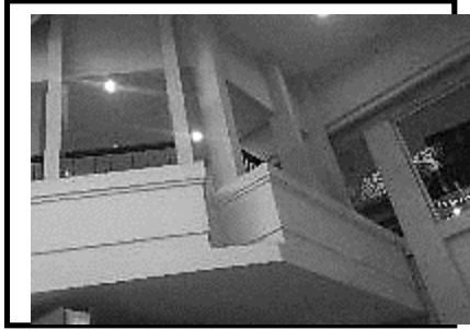
Gambar 14. Detail penyelesaian yang kurang baik Sumber: Dokumentasi pribadi, 2015
